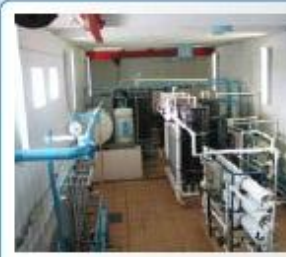
Рис. 2. Станция автономного водоснабжения (САВС) на космодроме «Байконур»
